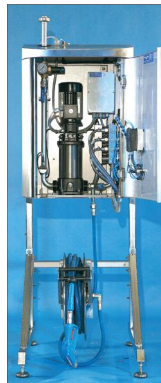
Versorgungsstation für die Zuführung der Reinigungsmittel
